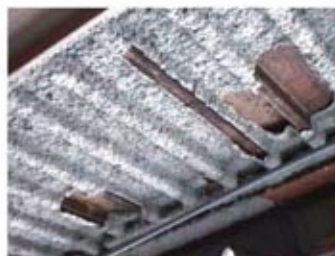
剥落したアスベスト
